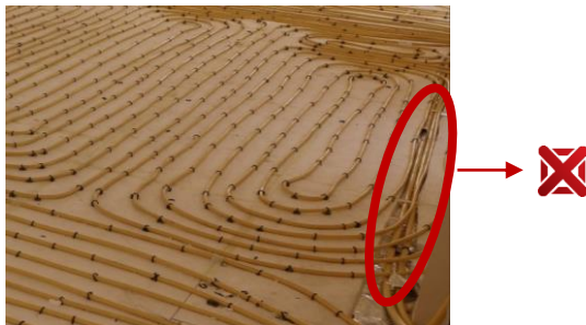
شکل ۵-۲ عدم اجرای لوله‌های اصلی ورودی و خروجی به کلکتور گرمایش از کف قبل از کف‌سازی اولیه و عایق‌کاری
