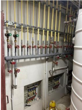
شکل ۵۱-۱ اجرای موتورخانه با محصولات سایز بزرگ BTS
