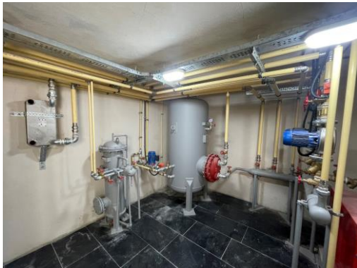
شکل ۵۲-۱ اجرای موتورخانه با محصولات سایز بزرگ BTS
