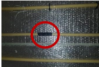
شکل ۱۸-۲ استفاده غلط از اتصالات در کف در سیستم گرمایش از کف
