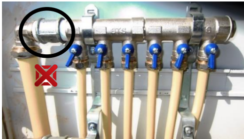
شکل ۳۷-۱ اجرای غلط استفاده از اتصالات گالوانیزه در کنار اتصالات برنجی
