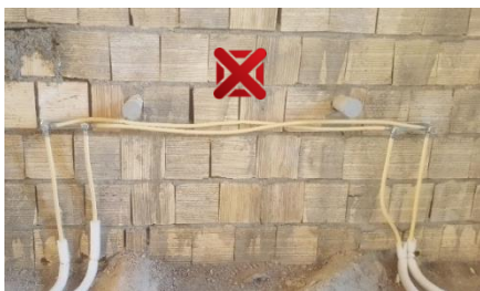
شکل ۱-۲۵ اجرای غلط - حرکت لوله به صورت افقی بر روی دیوار
