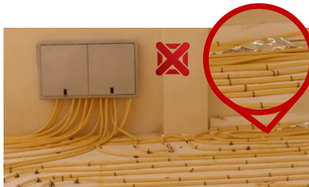
شکل ۱۹-۲ اجرای نامنظم و عبور لوله‌ها از روی یکدیگر
