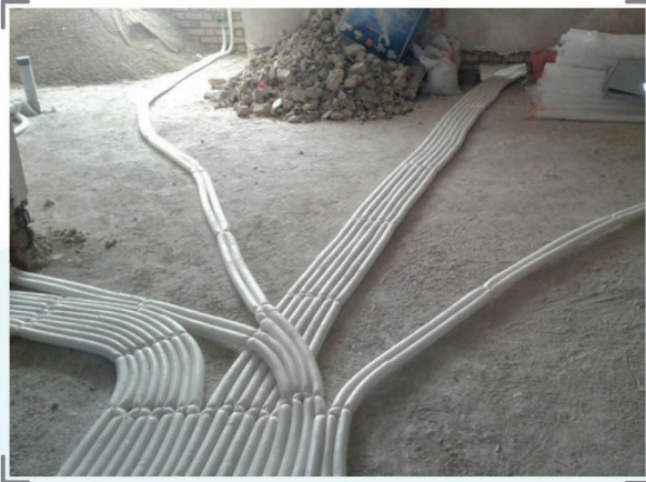
❌ شکل ۱- اجرای غلط لوله‌ها در سیستم گرمایشی
