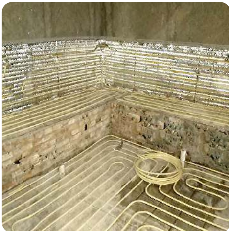
• گرمایش هم‌زمان سکوها و تکیه‌گاه حمام ترکی
